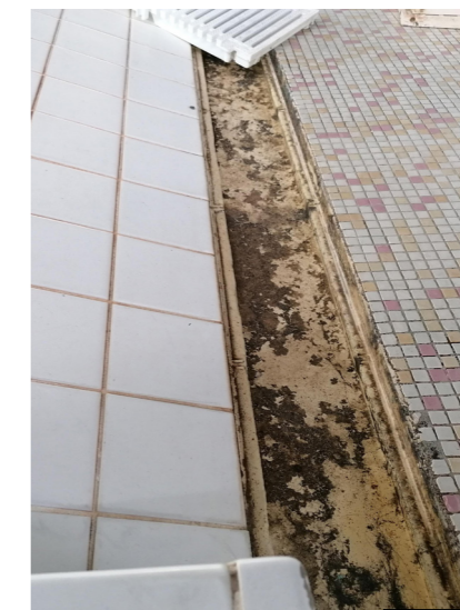
Etat des cunettes
