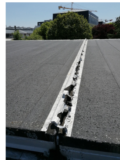
Etat de dégradation de la toiture
