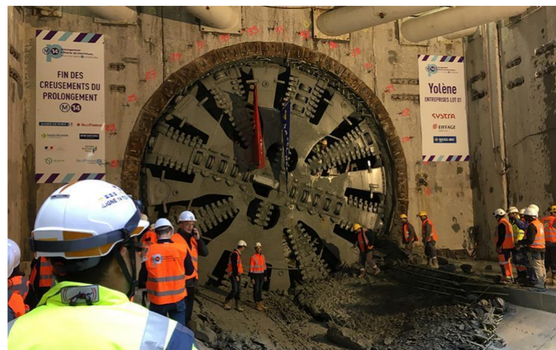
Figure 83 – Fin des creusements du second tunnelier Yolène entre Pont Cardinet et Clichy Saint-Ouen (Source : Eiffage)
