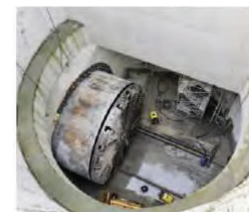
Puits de sortie du tunnelier pour le prolongement de la Ligne 12 du métro (source : RATP)
